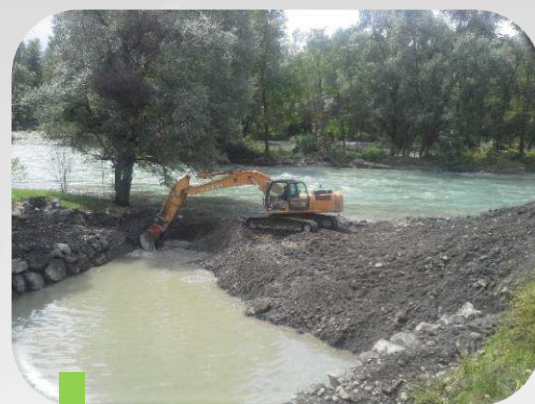
7 Phase de remise en eau : fin des travaux, remise en eau, démolition du batardeau
