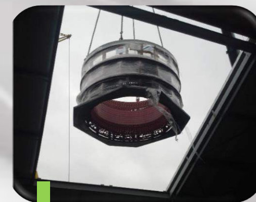
5 Phase de levage : mise en place du stator de l'alternateur, par le toit amovible
