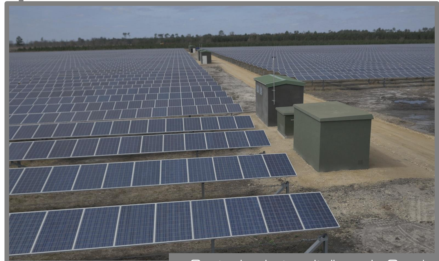
Centrale photovoltaïque de Garein
